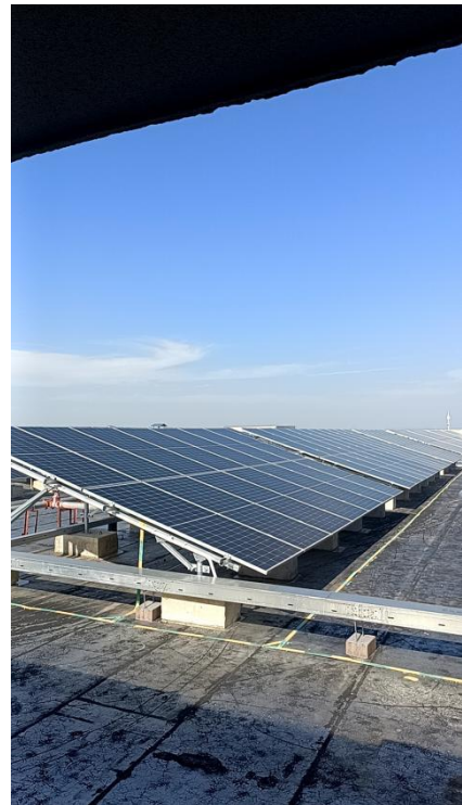
图 2-5 屋顶光伏照片
